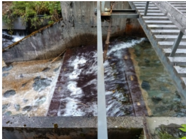
Prise d'eau de type « tyrolienne » sur le Vorz
