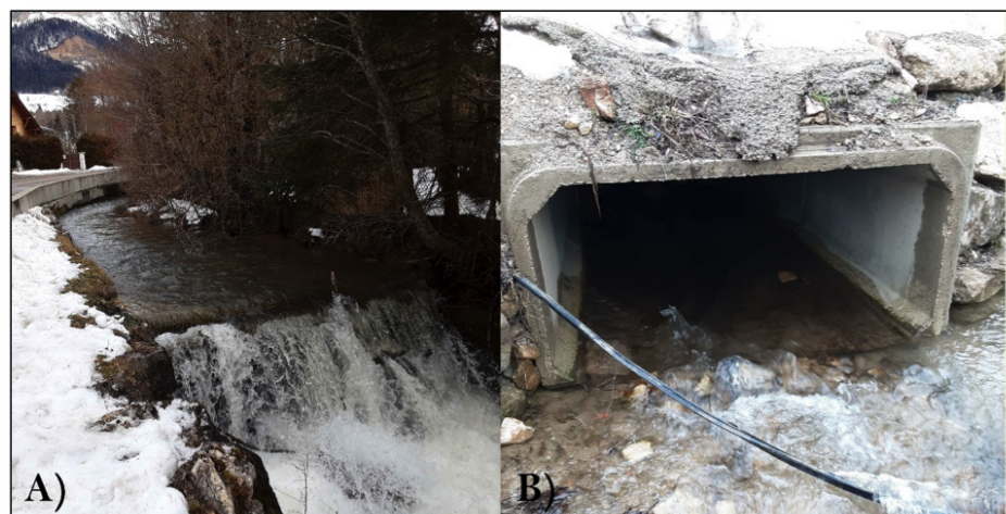
Exemple d'aménagements entravant la continuité écologique au Sappey : Seuil sur la Vence (A) et buse à la confluence Loue/Vence (B)
